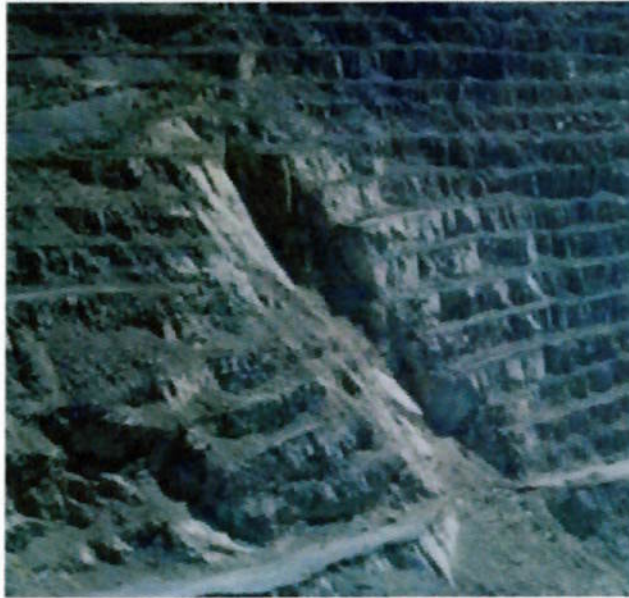
Figura 17 - Exemplo de falha em cunha na mineração.
